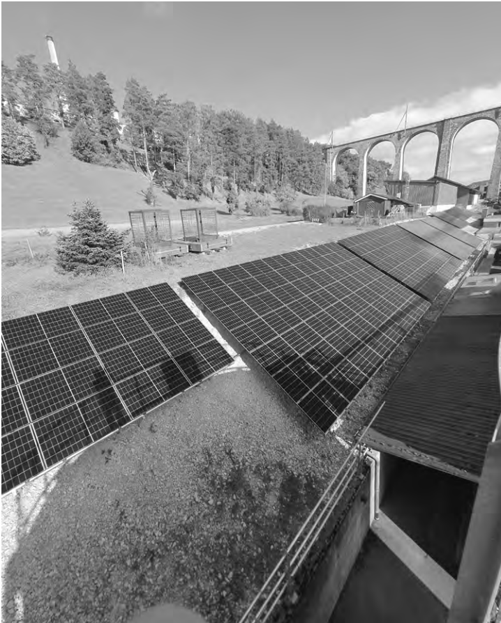
Das Bild zeigt die neue PV-Anlage mit 140 kW, die diesen Monat in Betrieb genommen wird.
